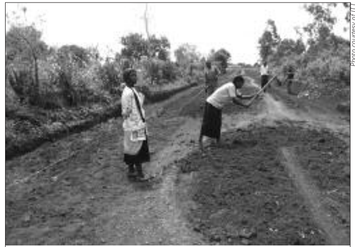
Mujeres y hombres trabajan lado a lado en la construcción del camino, Nyanza, Kenya.
